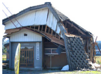
中越地震で被災した建物
